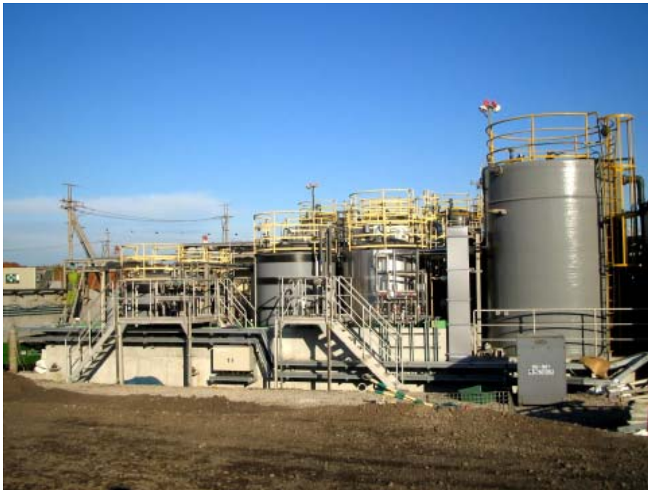
シアン水処理設備全景
